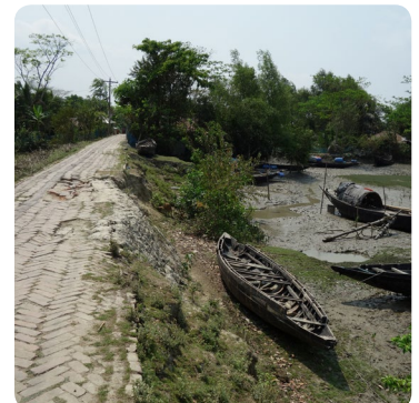
Beschädigter Deich in Chila
